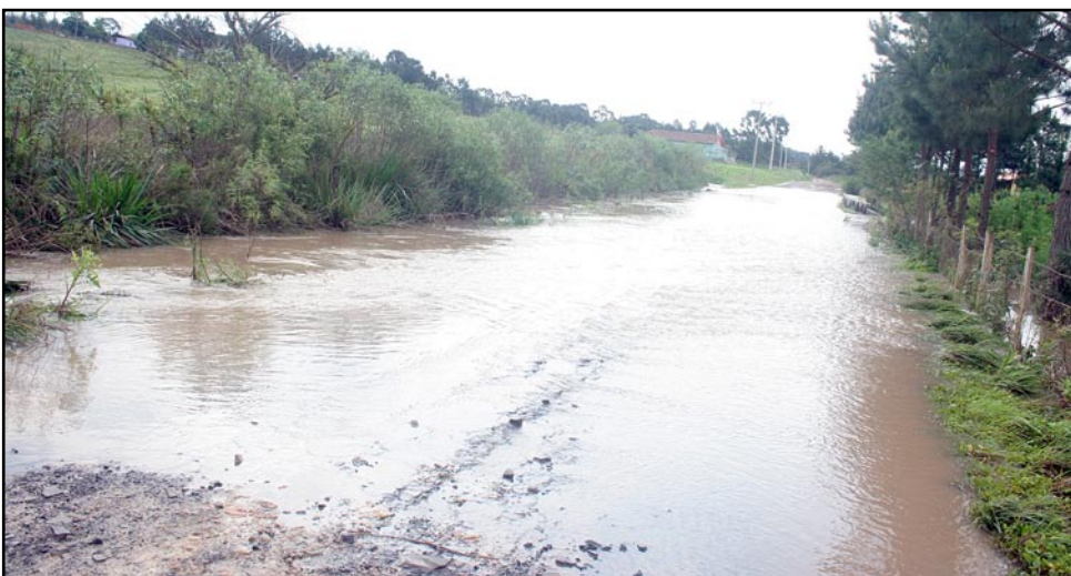
▲ Inundação de bueiro na localidade de Saltinho do Canivete
