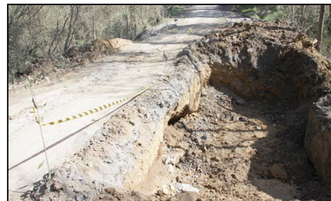
▲ Bueiro na localidade de Bituva Papuã não suportou o volume de água
